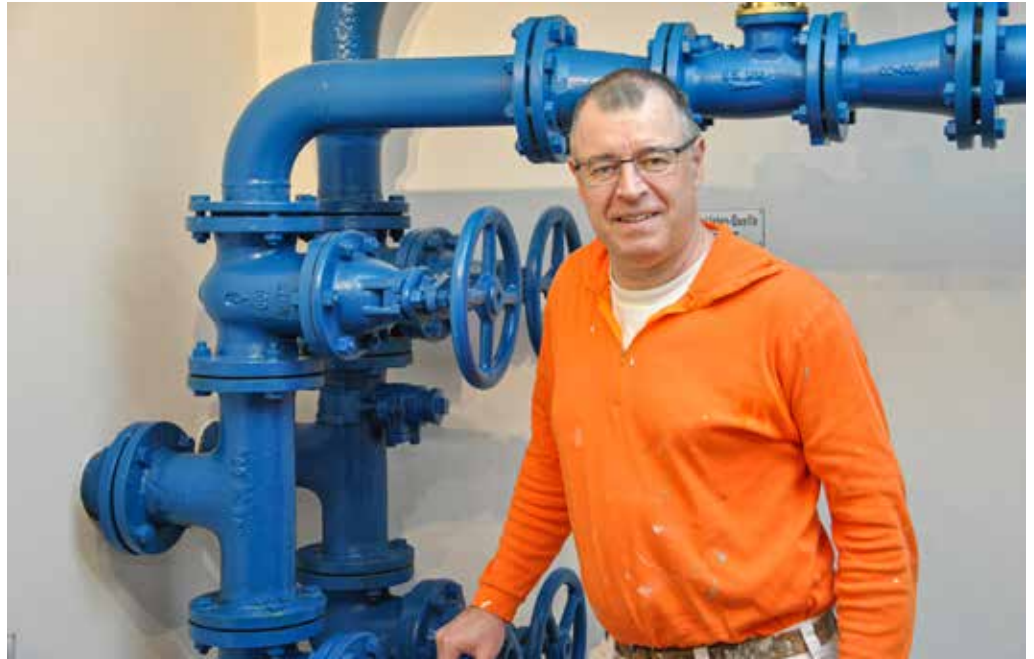
Das Bürgerhaus hatte früher als Pumpstation gedient. Die entsprechenden Wasserrohre im Keller sind immer noch intakt.
